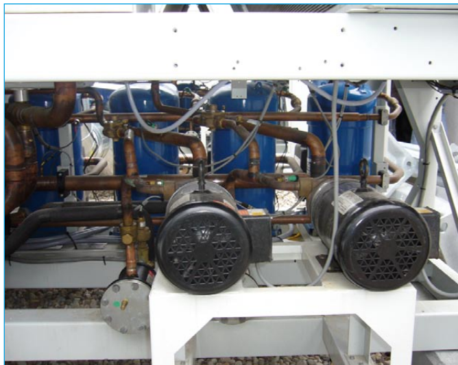
Rys. 2. Pompy obiegowe freonu w systemie DX free-cooling
